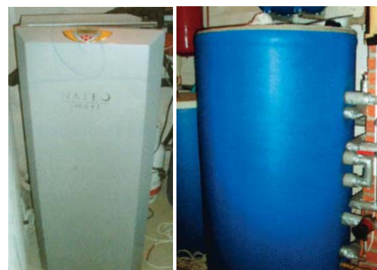
Pompa ciepła i 500-litrowy zbiornik c.w.u.
