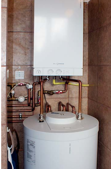
▲ Dom ogrzewany jest wiszącym kotłem gazowym firmy Viessmann
